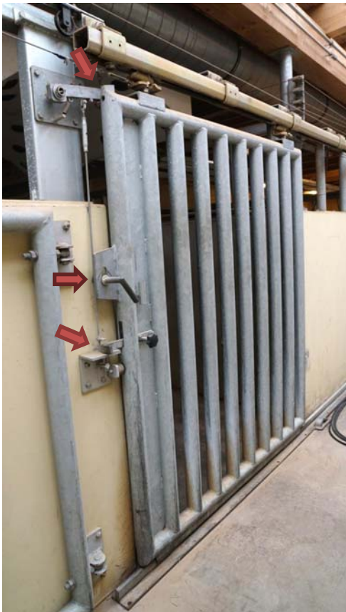
Abb. 1: Nashorntor mit mehrfacher Sicherung
